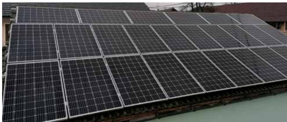
Streha domače elektrarne
